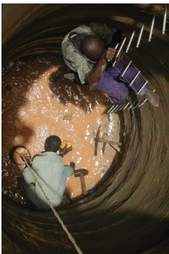
Evacuation eau en fonds de puits
